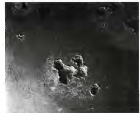
Oberflächenzerstörung des Tanks durch Mikroorganismen und die chemisch-elektrolytischen Reaktionen
